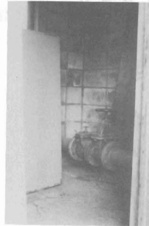
ポンプ小屋の内部
