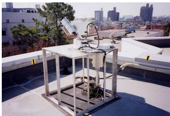
写真 太陽追尾装置全景
